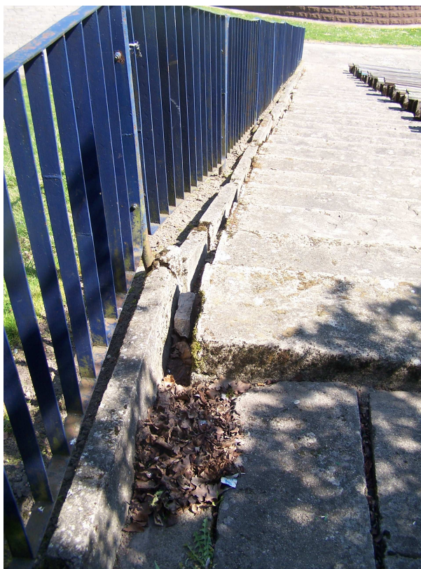
Fot. 3.4. Szczelina powstała w wyniku przemieszczenia naroża skarpy
