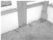
Fragment ściany zewnętrznej z widocznymi uszkodzeniami warstwy zewnętrznej ściany.
