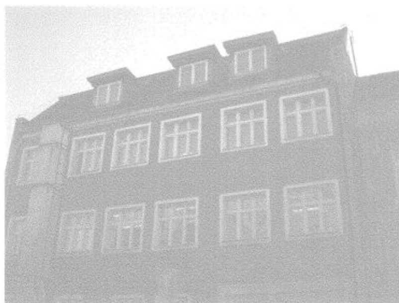
Fragment elewacji tylnej z widocznymi parapetami do wymiany
